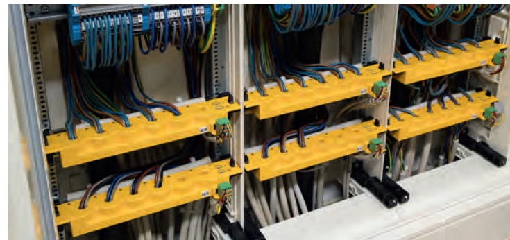
Differenzstrom-Überwachungsgeräte vom Typ RCMS150 in der Installation.
